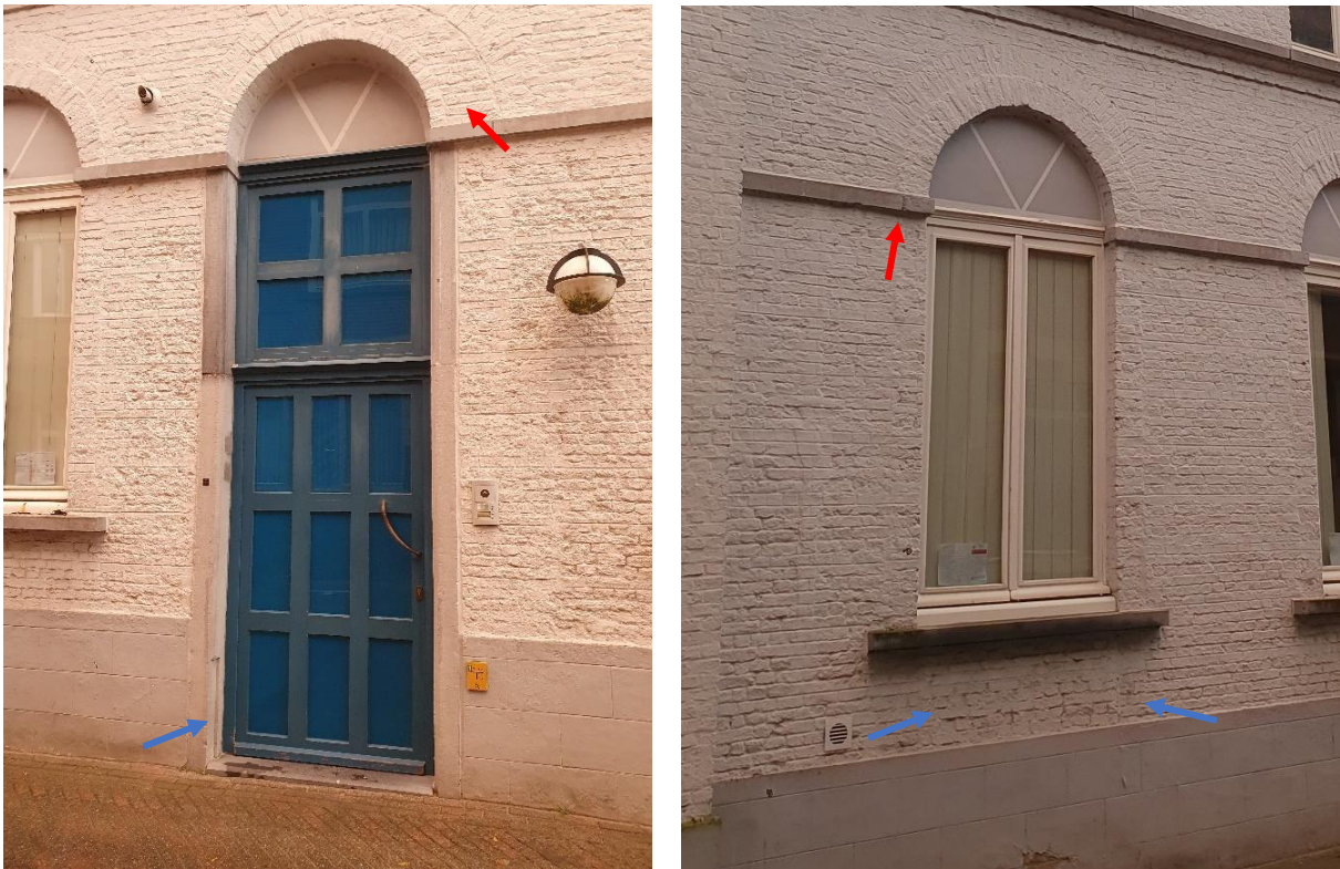
Fig. 86: Links: Het huidige schrijnwerk werd bij de restauratie geplaatst, de deuropening was daarvoor reeds versmald. De oorspronkelijke deurbreedte kan nog aan de ontlastingsboog bovenaan afgelezen worden (rood). Aan de openstaande verbinding onderaan de linker deurstijl (blauw) te zien betreft dit recuperatie. Rechts: De vensters zijn voorzien van schijnbovenlichten, deze werden waarschijnlijk dichtgemaakte bij het verlagen van de plafonds vanbinnen. Waarschijnlijk is de schildering van de radiale indeling van het bovenlicht een herneming van het voorgaande raamschrijnwerk, maar stak de raamnaald wel verder door zoals ook op de verdiepingen te zien was, dit is typisch voor vroeg-19 de -eeuwse ramen. Ter hoogte van de borstwering kan gezien worden dat de opening verder doorliep naar onder. Rondom rond de vensters is een band van afwijkend metselwerk te zien dat er op wijst dat de vensters oorspronkelijk groter waren, ook de naad in de cordon (rood) bevestigt dit.
