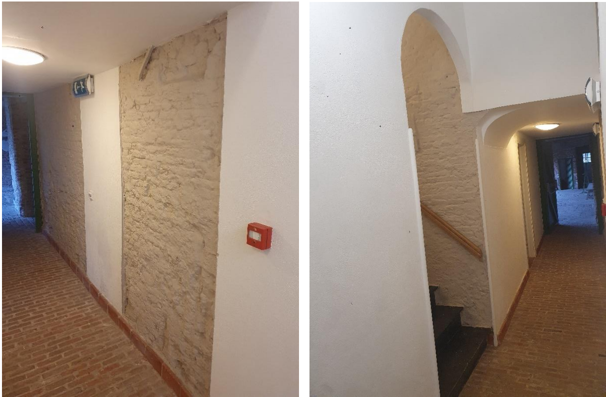
Fig. 152: Plaatselijk werden delen van de 16 de -eeuwse gevel van de molen bloot gelaten (links). De rondboogopening vormt de vormentaal van de vensters in de gevel en is typisch voor rond de empireperiode (rechts).
