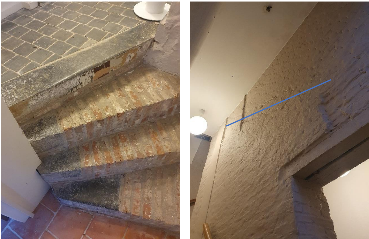
Fig. 155: Links: Bakstenen trapje met (gerecupereerde?) hardstenen hoekelementen. Rechts: Schuin bouwspoor van vermoedelijk een voormalige traparm over de gehele wand van de traphal (blauw).
