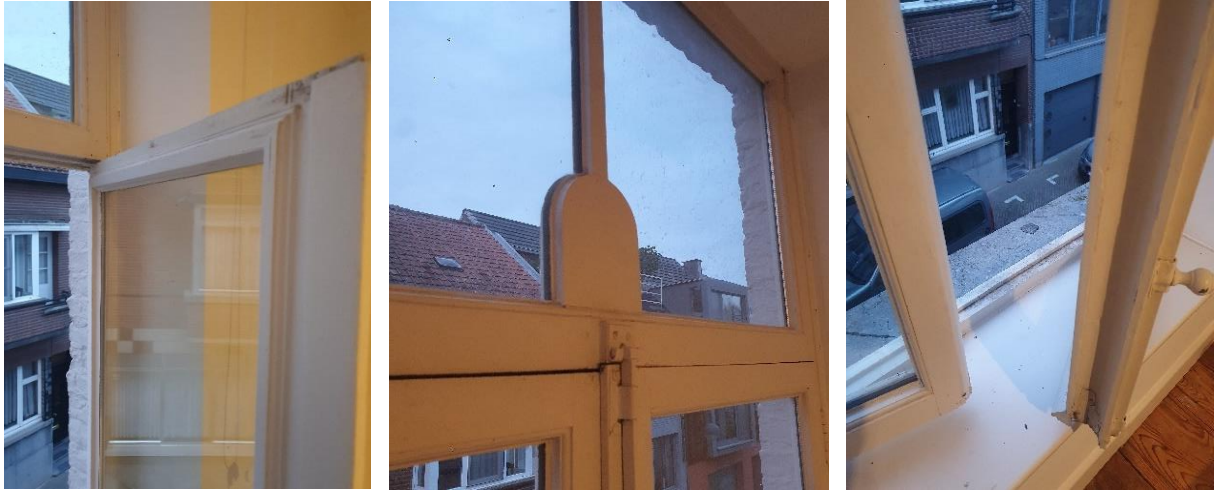
Fig. 167: Bij het plaatsen van het dubbel glas in de bestaande profielen werden opleglaten gebruikt en werd de oorspronkelijke roedeverdeling in de raamvleugels achterwege gelaten (links), de roedeverdeling op het bovenlicht werd op het nieuwe glas geplakt (midden). De oorspronkelijke spanjolet werd reeds vervangen aangezien de halfronde uitstulping diende om een vroeg type van spanjolet in te laten sluiten. De wolfbek (rechts) geeft aan dat deze ramen tijdens een andere periode geplaatst zijn dan de gelijkvloerse.
