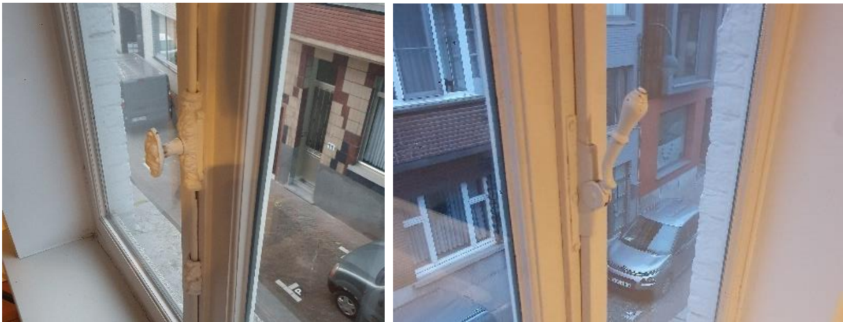
Fig. 168: Draaikruk op alle spanjoletten (links), behalve één uitzondering met hendel (rechts).
