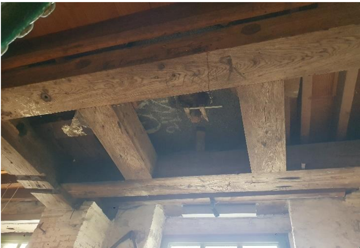
Fig. 111: Voorbeeld van de secundaire structuur die aan de primaire bevestigd werd ter ondersteuning van de bovenliggende steenkoppels.
