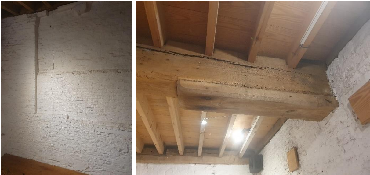
Fig. 135: Trapsgewijze verjonging van de westwand, vermoedelijk om materiaal te besparen (links). De moerbalken hebben balksleutels, maar zijn hier niet opgelegd op consoletjes (rechts).
