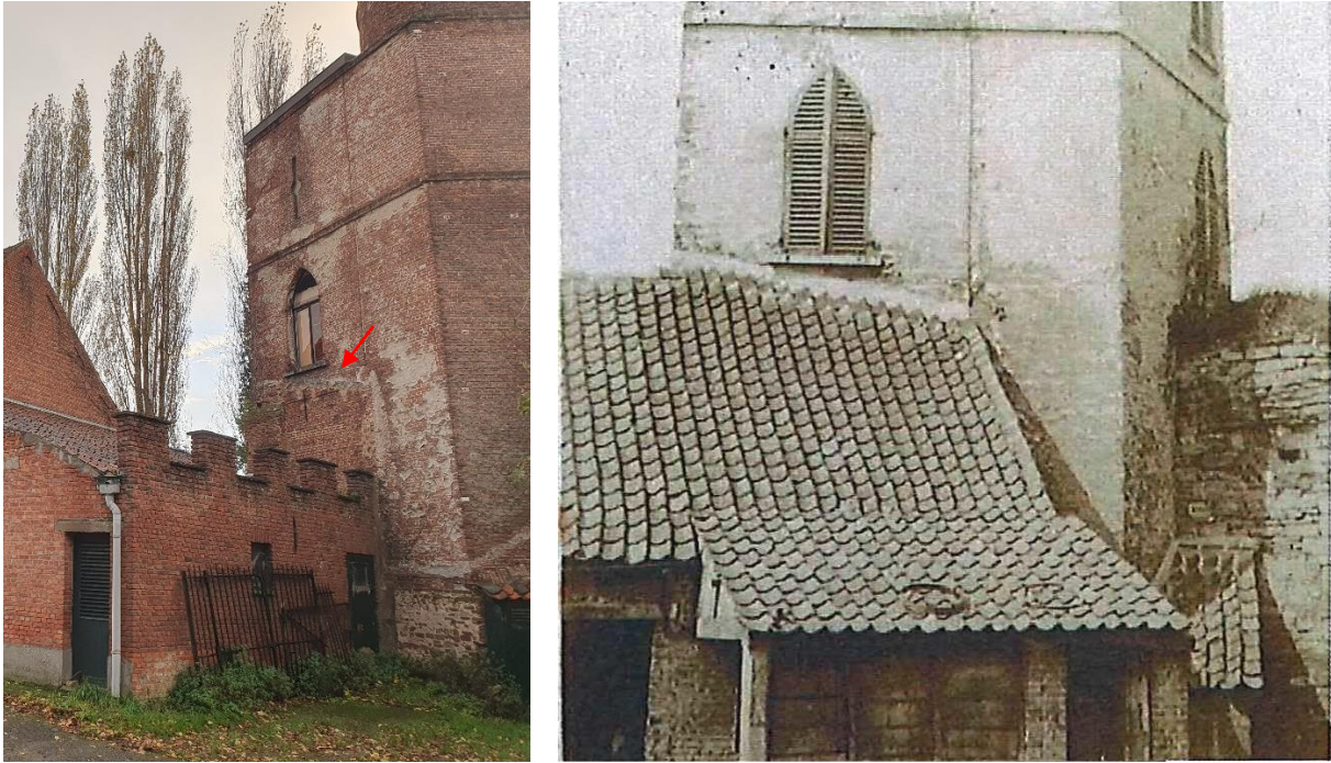
Fig. 81: Op de gevel is heden de afdruk van het verdwenen dak dat op een oude foto nog te zien is duidelijk afleesbaar.
